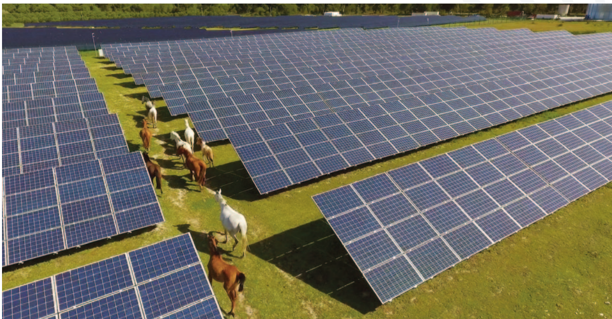
14 MW, Coruche, Santarém, Portugal.
